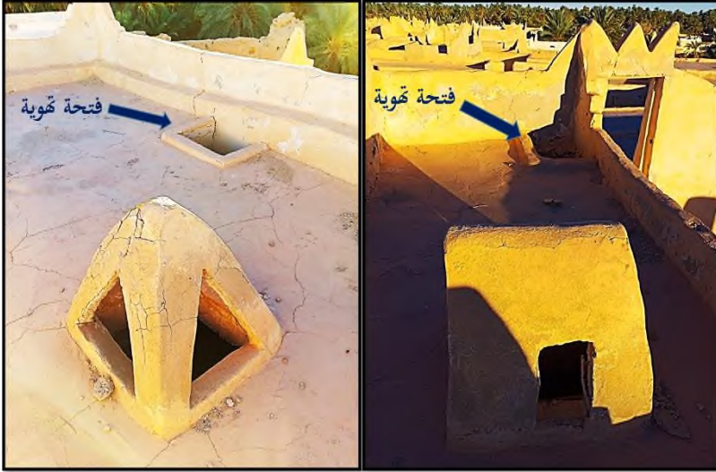
شكل رقم (27) صورتان منفردتان توضح كل واحدة منهما تواجد فتحة تهوية ومدخنة في مطبخ واحد.
